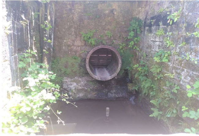
Figure n°51 : PK144 Prise d'eau 2 Aval vanne (12/06/23)
