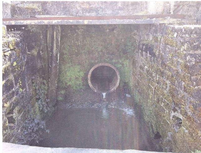
Figure n°49 : PK144 Prise d'eau 2 Aval vanne (22/03/23)
