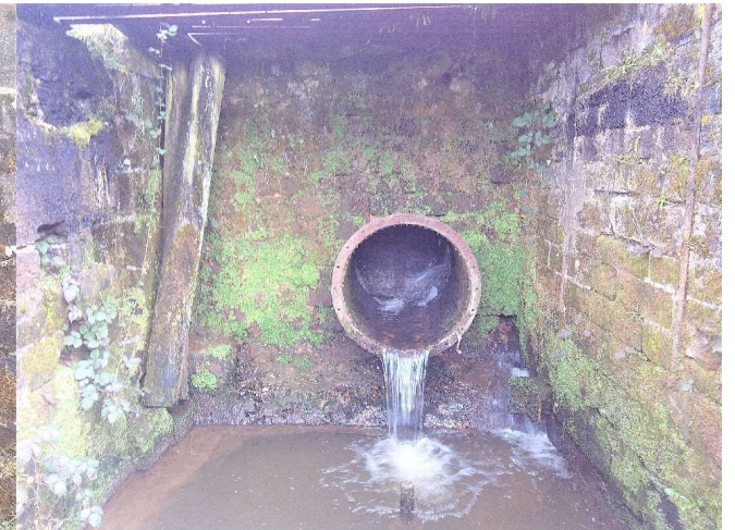
Figure n°50 : PK144 Prise d'eau 2 Aval vanne (25/03/23)
