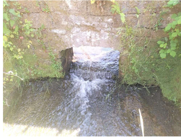
Figure n°46 : PK144 Prise d'eau 1 Aval vanne (12/06/23)
