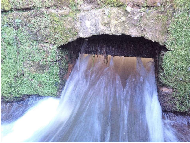
Figure n°45 : PK144 Prise d'eau 1 Aval vanne (25/03/23)
