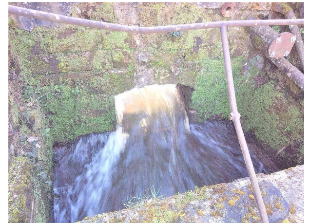
Figure n°44 : PK144 Prise d'eau 1 Aval vanne (22/03/23)
